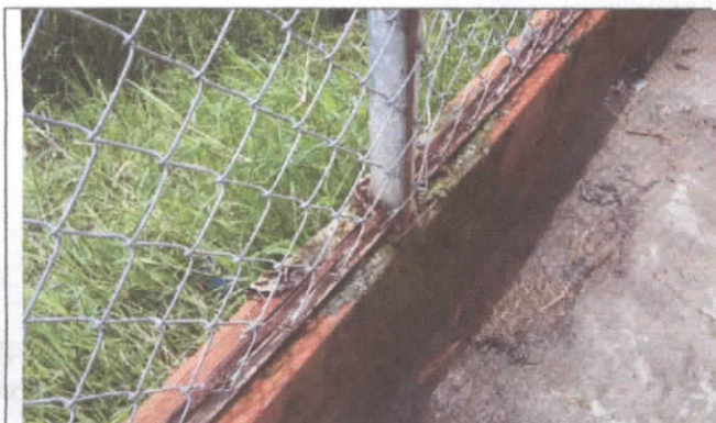
47. Acero estructural expuesto y falta de platinas en los ángulos
