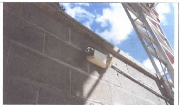
10. Iluminación de emergencia
