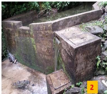
Bocatoma y Tanque desarenador
