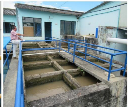
COMPONENTES DE FLUCULACION, FILTROS
