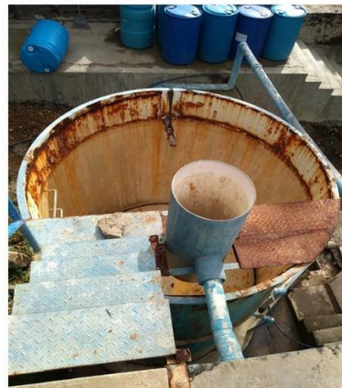
UNIDAD DE FILTROS PTAP
