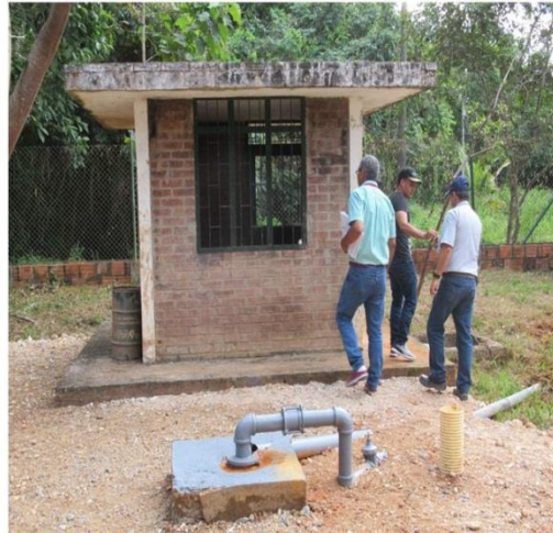
Fuente 2 de abastecimiento pozo profundo
