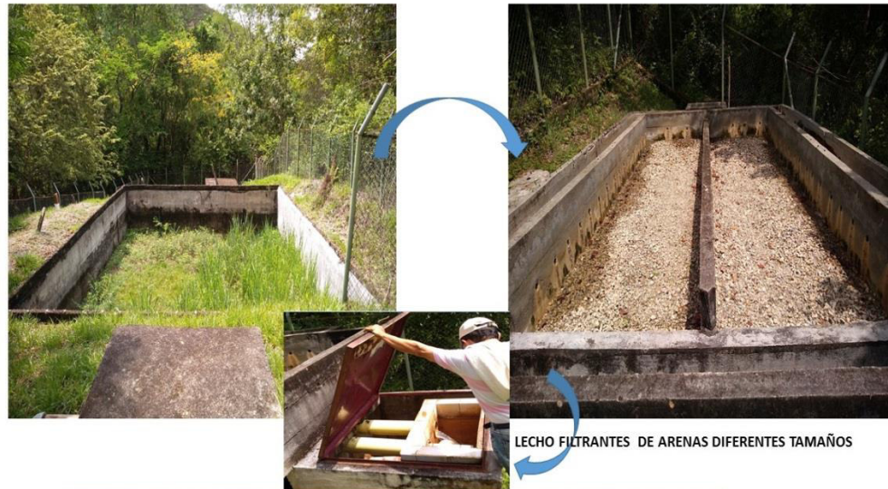
BOCATOMA 2 , COMPONENTE DE TRATAMIENTO QUEBRADA LUCHA DENTRO, COELLO -TOL
