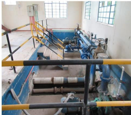
CASA DE MAQUINAS PARA EL BOMBEO DE AGUA CRUDA
