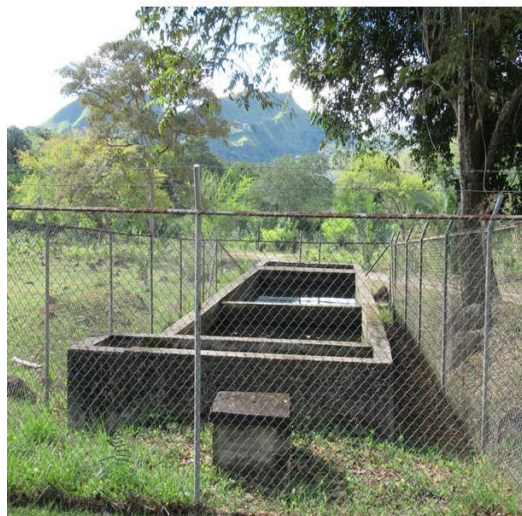
Tanque desarenador en la zona de captación del Agua
