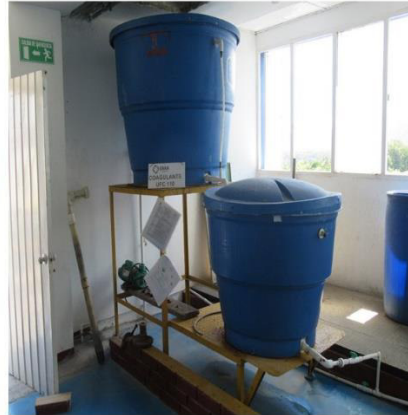
ESTACION DE APLICACIÓN DE CLORO GASEOSO
