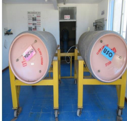
ESTACION DE APLICACIÓN DE CLORO GASEOSO
