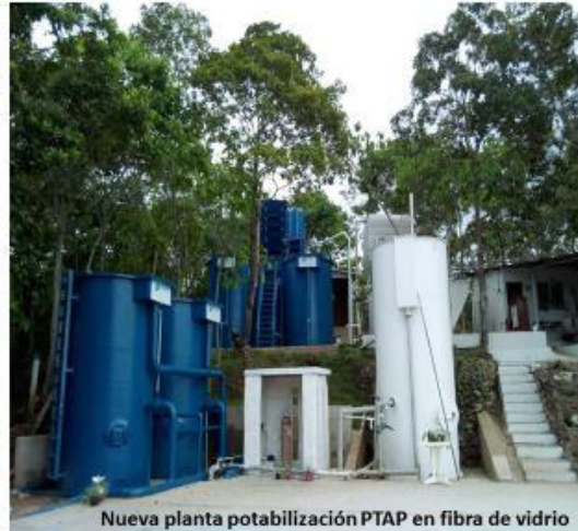
Nueva planta potabilización PTAP en fibra de vidrio
