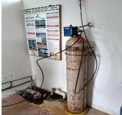
DISPENSADOR DE CLORO GASEOSO
