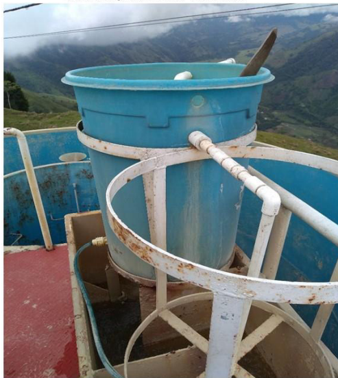
Unidad aplicación de floculado
