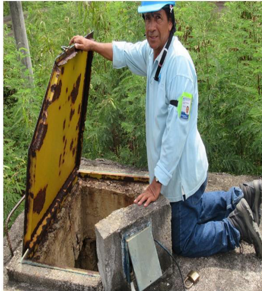
Tanque distribución de agua potable
